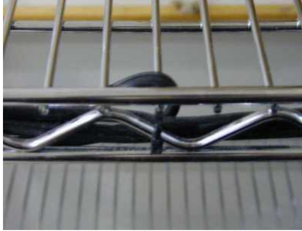
الشكل 5: تغليف الأسلاك داخل وحدة الأرفف
